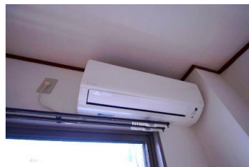
エアコン1台設備
